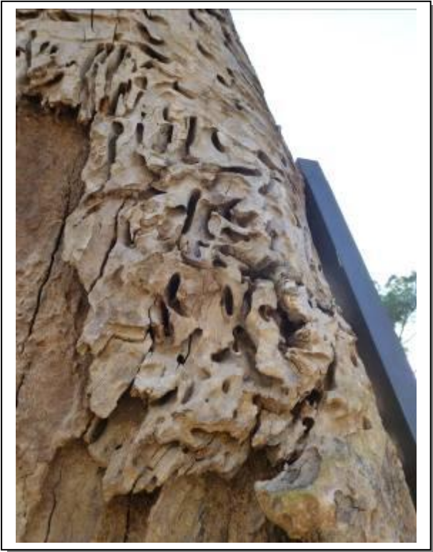
2. Detalle de las galerías producidas por en Cerambyx sp.
