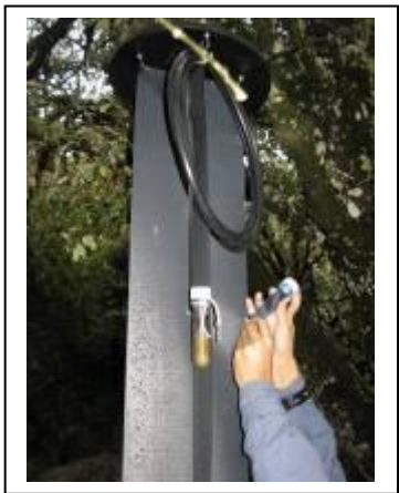
15. Col·locació pots efluent
