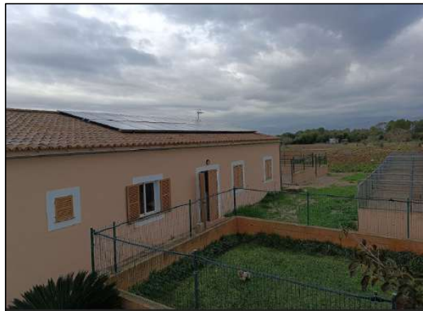
Imagen 10. Instalación fotovoltaica de autoconsumo de Son Batlet (fuente: proyecto)
