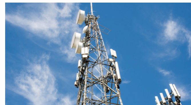
Noves infraestructures de telecomunicació.
