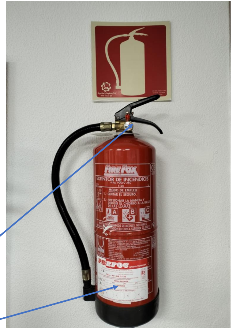
Extintor. Mirar manòmetre i caducitat
