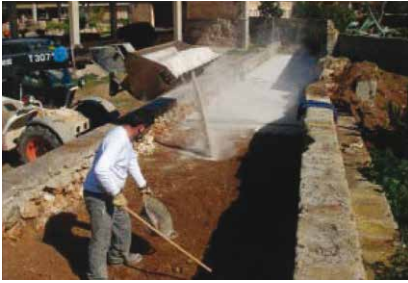
Construcción de muretes y vaciado de tierras. Construction of walls and drainage of lands.
