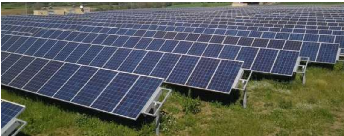
Ejemplo de cómo quedaría el campo de placas solares y su efecto sobre el suelo. Esta imagen sería sin tareas de cultivo entre hileras de placas.
