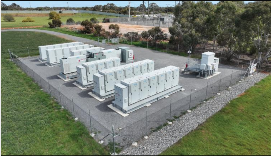
ILUSTRACIÓN 6 EJEMPLO DE SISTEMA DE BATERÍAS
