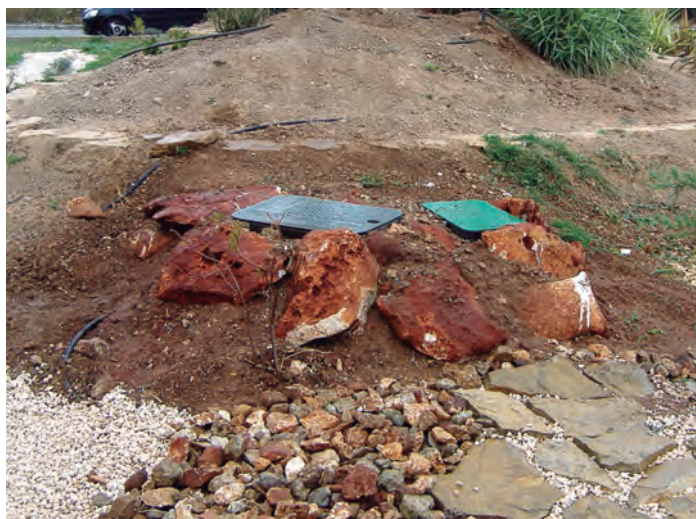
Instal·lació de reg subterrani
