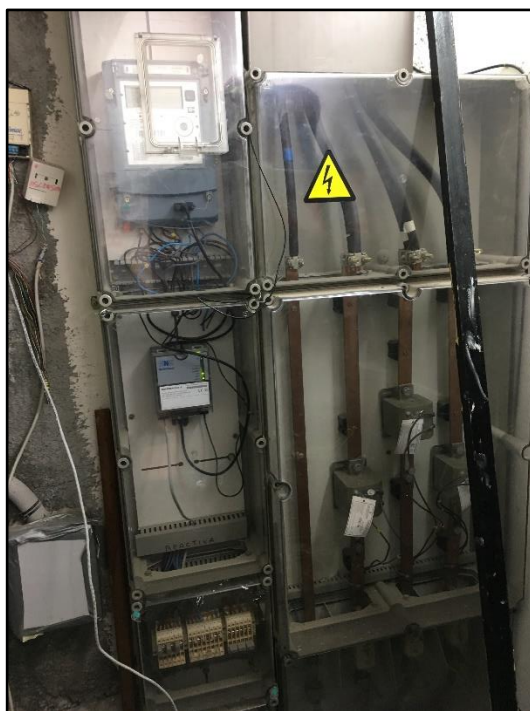
Il·lustració 38. Escomesa elèctrica
