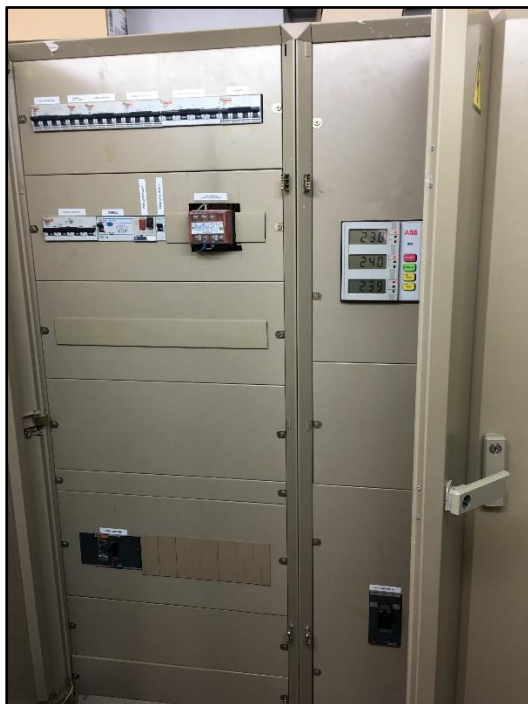
Il·lustració 37. Quadre elèctric general
