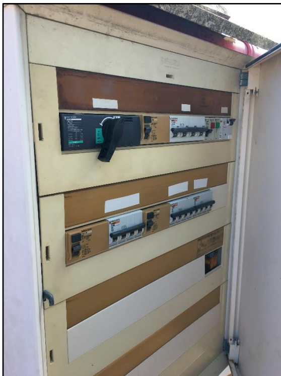
Il·lustració 35. Quadre elèctric climatització
