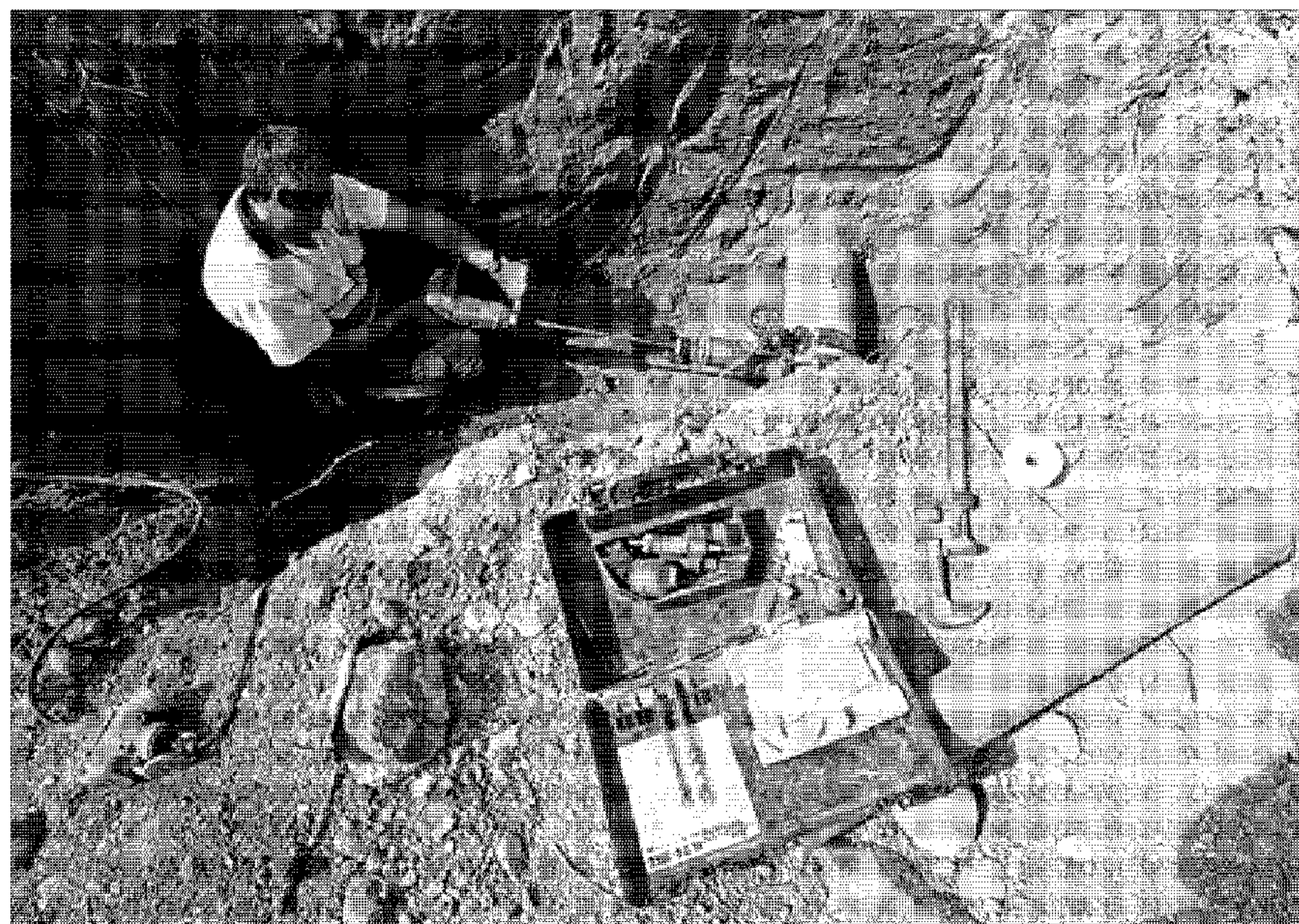
Un técnico de Aqualia reparaba ayer la avería junto a la autovía del aeropuerto
