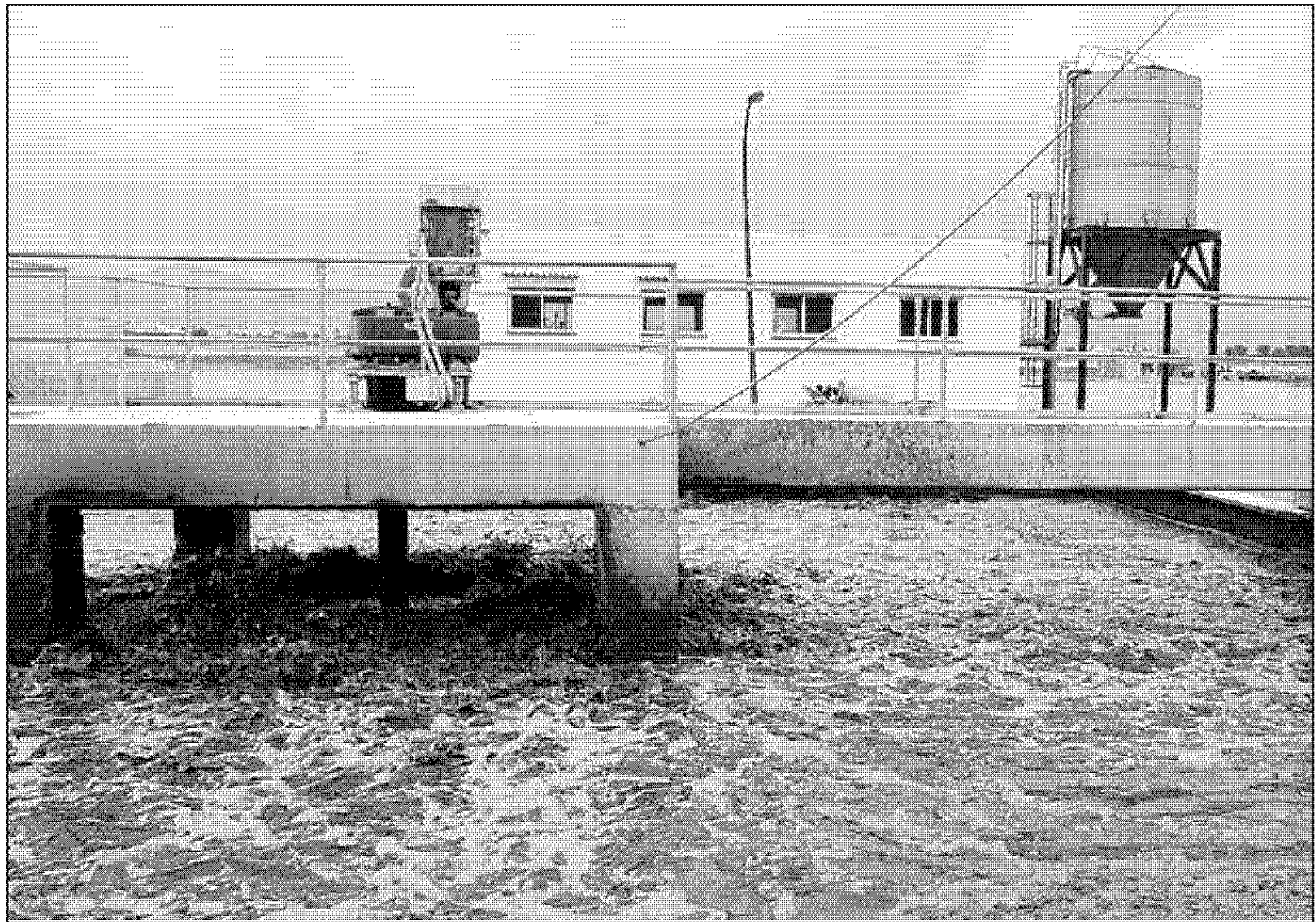
Una imagen de la depuradora de Platja d'en Bossa.
