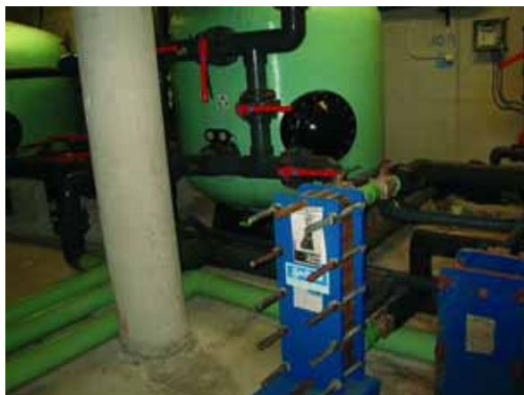
Bescanviador de calor.
