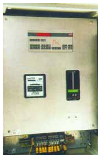
Caseta de control de dades.
