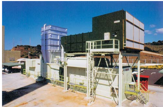
Turbines de gas.
