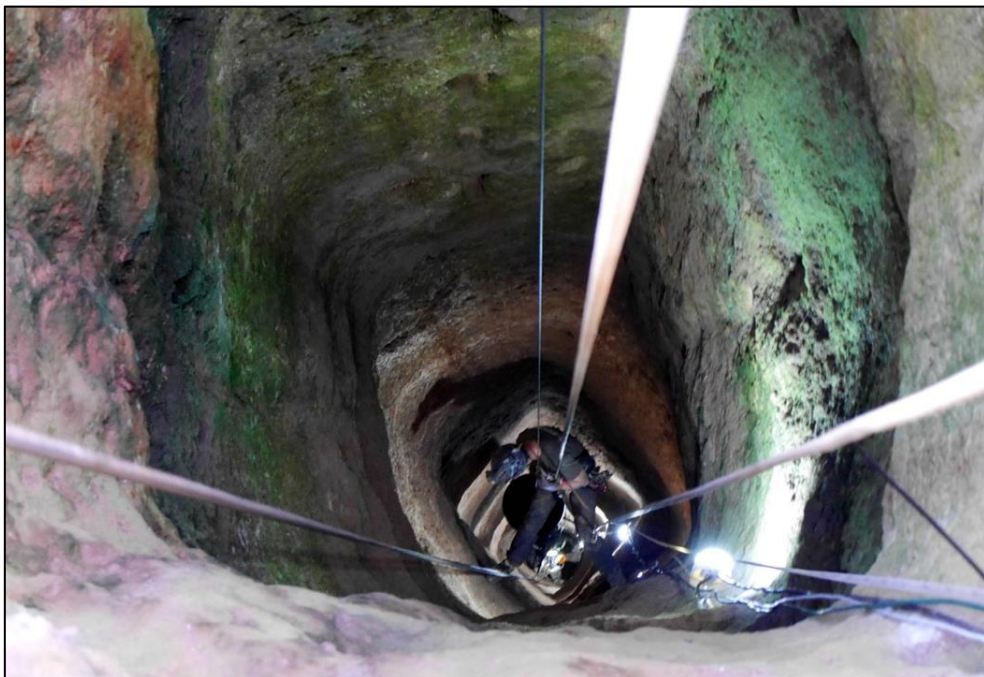
Pozo iluminado por sistema eléctrico instalado. Descenso con grúa y doble cuerda
