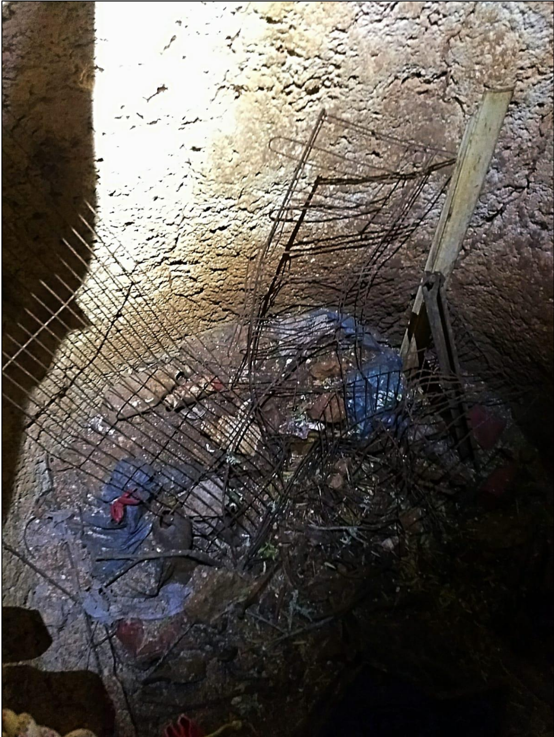
Basura en el interior del pozo.
