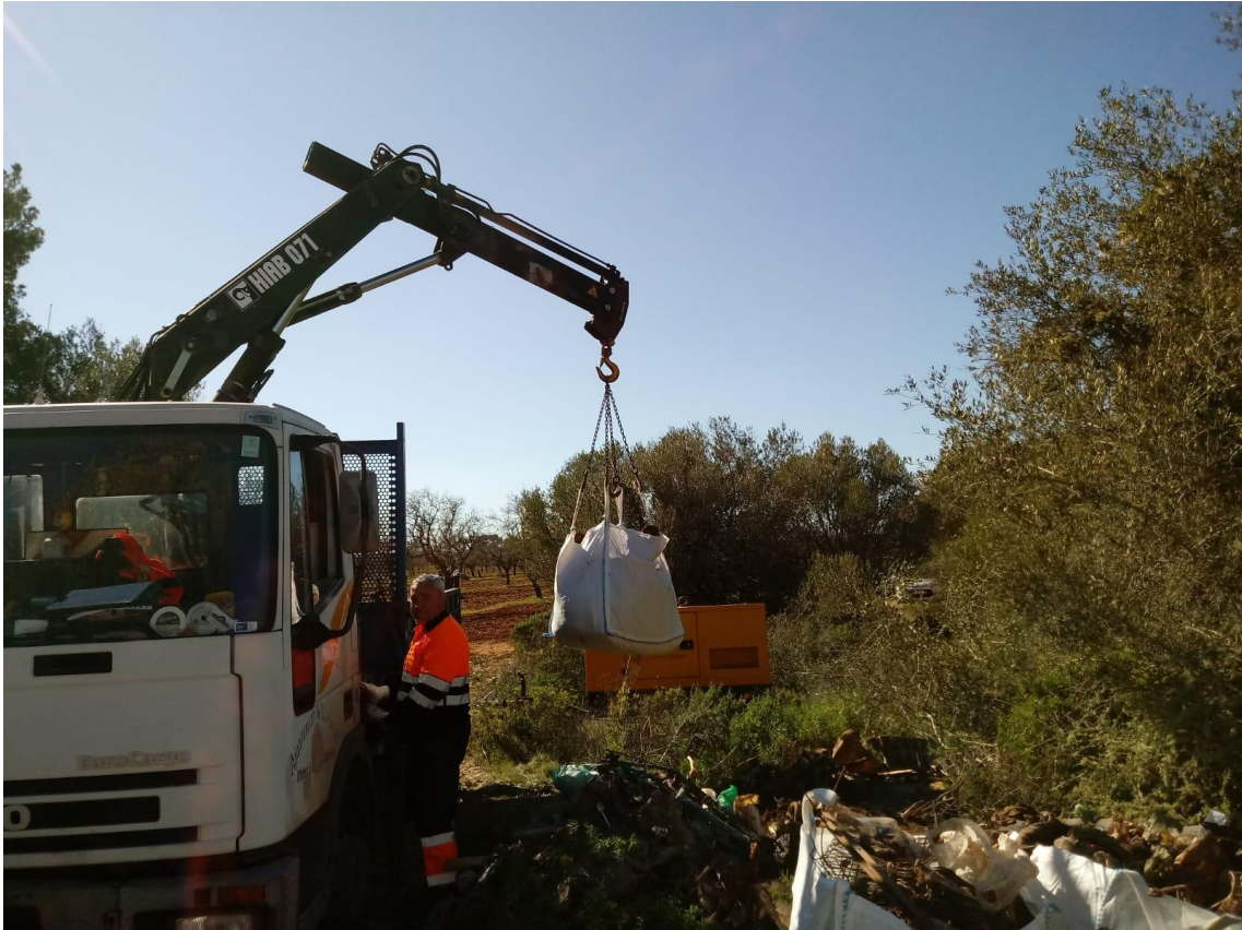
Recogida de la basura y escombros del interior del pozo por servicios del Ayuntamiento de Lluçmajor.
