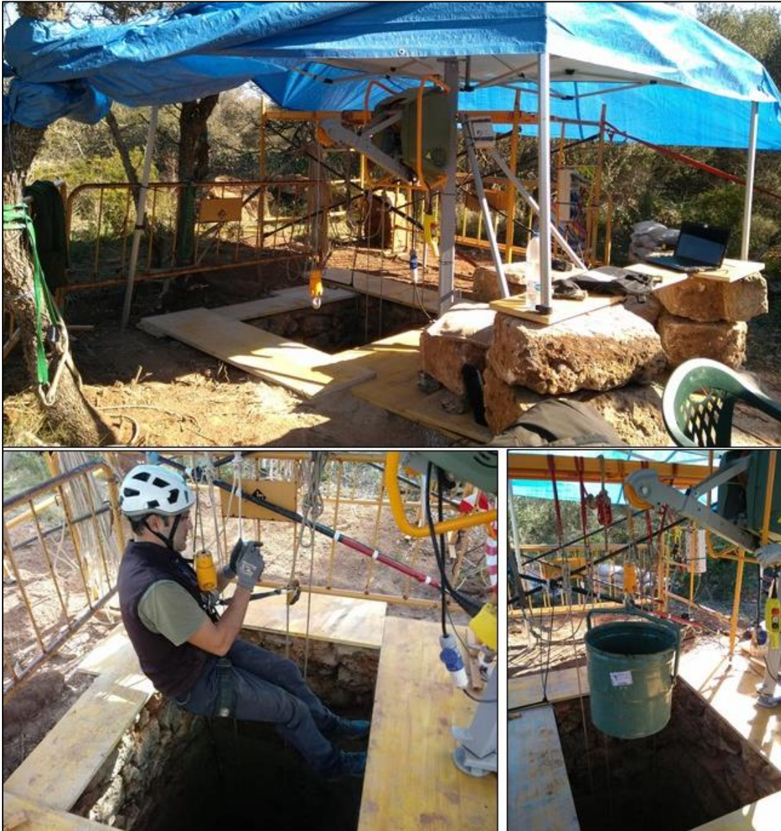
Arriba. Elevador y sistema de seguridad instalado. Abajo. Imágenes de un técnico y la cubeta de limpieza al comienzo del descenso mediante grúa y doble cuerda.
