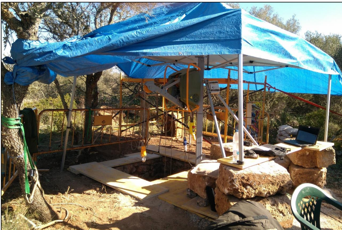
Elevador eléctrico en la boca del pozo.
